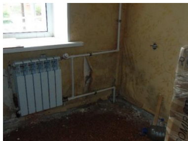
Рис.1. Пример разрушения внутренней отделки помещений
