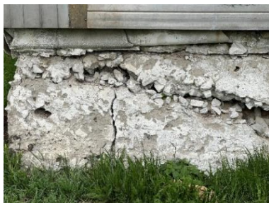
Рис.3. Пример монолитной бетонной конструкции (цоколя), с трещинами и косослоем бетона
