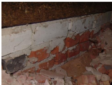
Рис.2. Пример кирпичной кладки, выполненной с нарушениями
