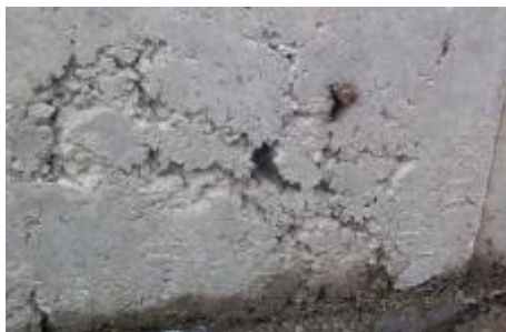
Рис. 1 Пустоты и полости с наружной стороны стены из-за неправильного вибрирования бетона
