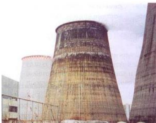
Рис.1. Фото железобетонной оболочки вытяжной башни градирни с признаками термической деструкции. Заимствовано из [9].
