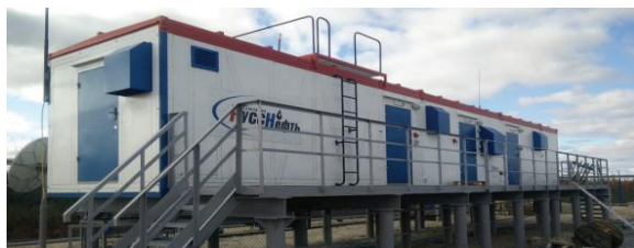
Рис.1 Автономный энергокомплекс ЭНЕРГО-К18М3.3.G40-6/3, установленный на объекте нефтяной компании «РуссНефть»
