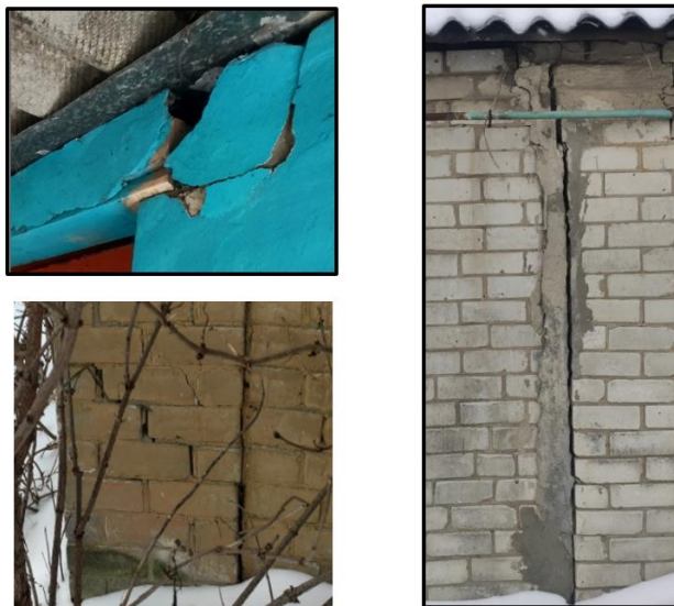
Рис. 2. Внешние повреждения и дефекты жилого дома
