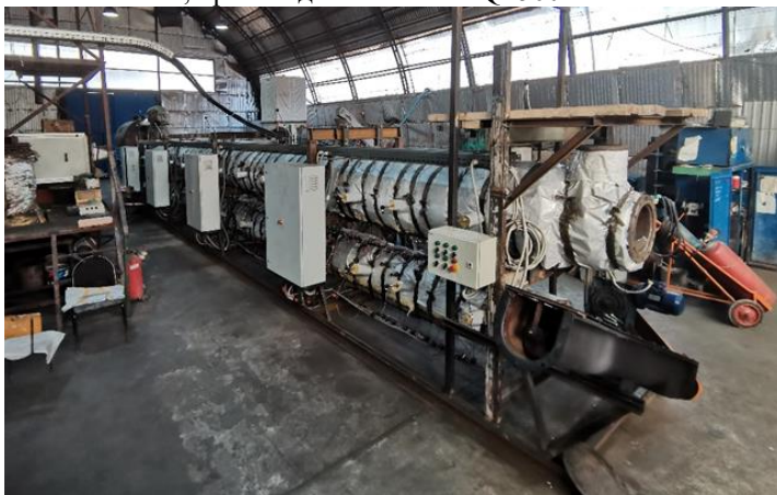
Рис. 3. Общий вид опытно-промышленной установки низкотемпературного термолиза на производственной площадке ООО «ТК «Экотранс» в стадии сборки и монтажа оборудования.
