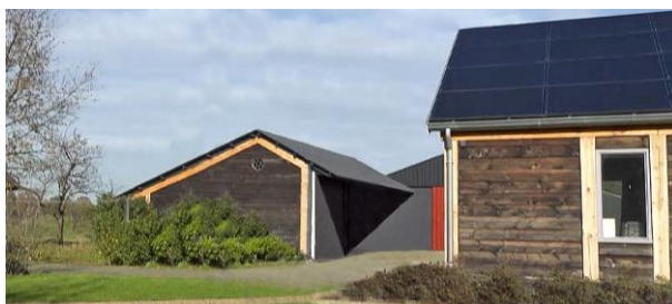
Рис.3 Фотоэлектрические панели на кровле хозяйственных построек
