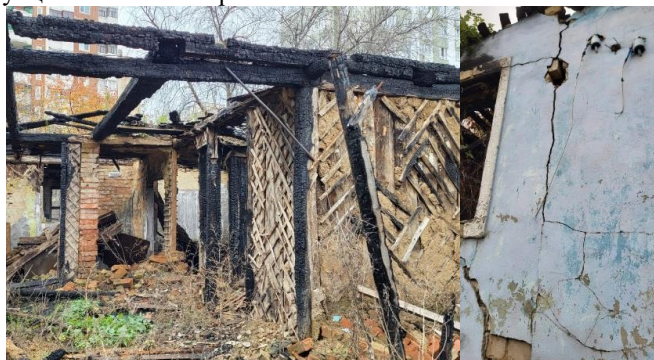
Рис. 1. Внешние повреждения и дефекты жилого дома
