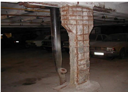
Рис. 1 Коррозионные повреждения цементного бетона и стальной арматуры
