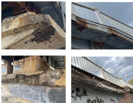
Рис. 1 Внешние повреждения и дефекты моста со смайликами через ж/д пути Москва – Юг
