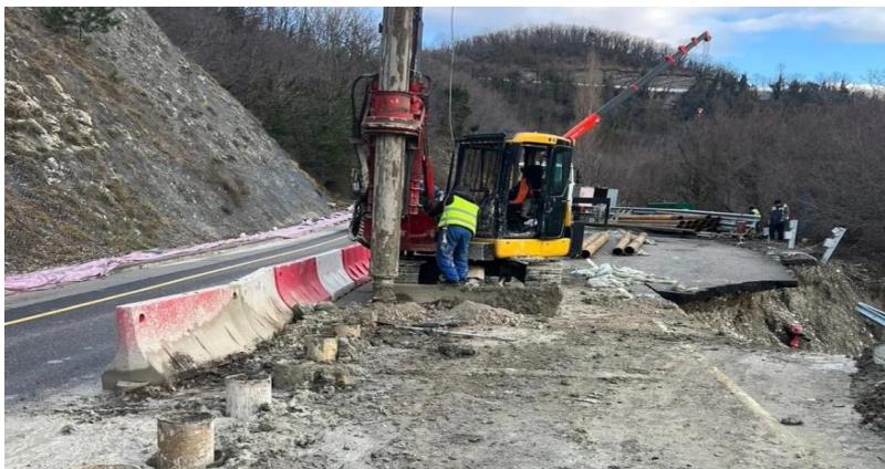
Рис. 2 Последствия оползня в Краснодарском крае
