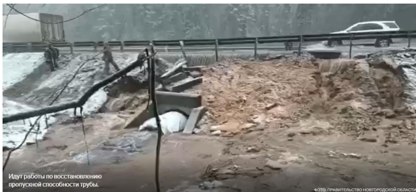
Рис. 1 Результат подтопления дороги Новгородской области
