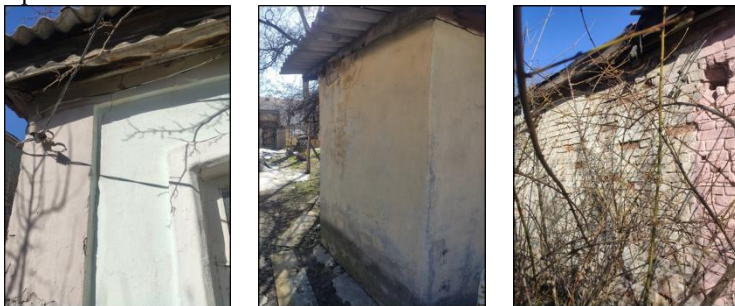
Рис. 2 Внешние повреждения и дефекты жилого дома
