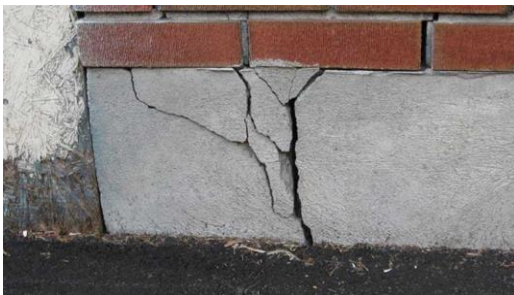
Рис. 2 Трещины в фундаменте, образовавшиеся в результате морозного пучения
