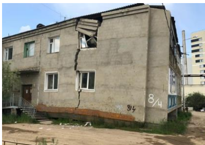
Рис. 5 Частичное обрушение несущей стены и разрушение сваи дома по ул. Автодорожная, 8/4 в г. Якутск из-за скопление талых вод под зданием
