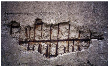
Рис. 1 Результат сульфатной коррозии бетона [10].
