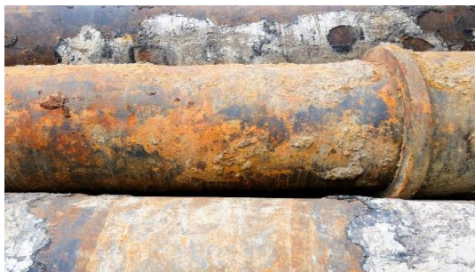
Рис. 1 Внешний вид коррозии морского трубопровода
