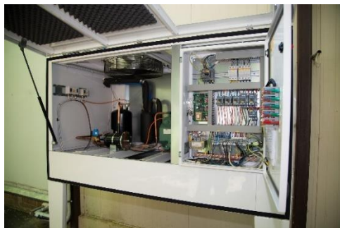
Рис. 2 Промышленная холодильная установка.
