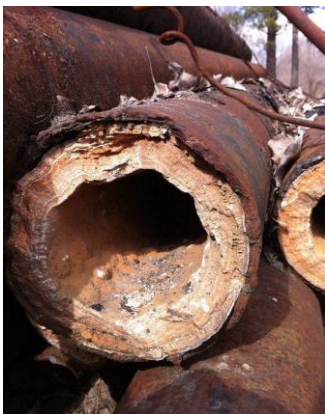
Рис. 2 Износ водопроводной трубы
