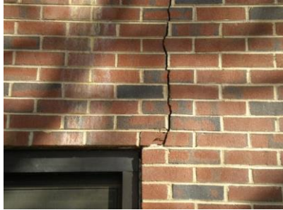
Рис. 1 Трещина в каменной кладке. Источник: https://sferastroiki.ru/
