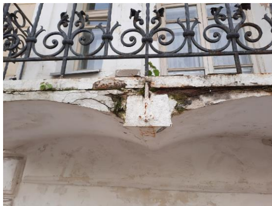
Рис. 2 Биокоррозия железобетонной плиты балкона
