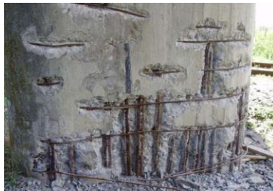
Рис. 2 Пример коррозии железобетона. Источник: https://him-kont.ru/
