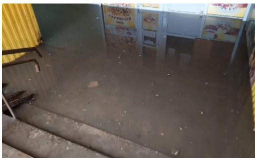
Рис. 2 «Затопление пешеходного перехода»
