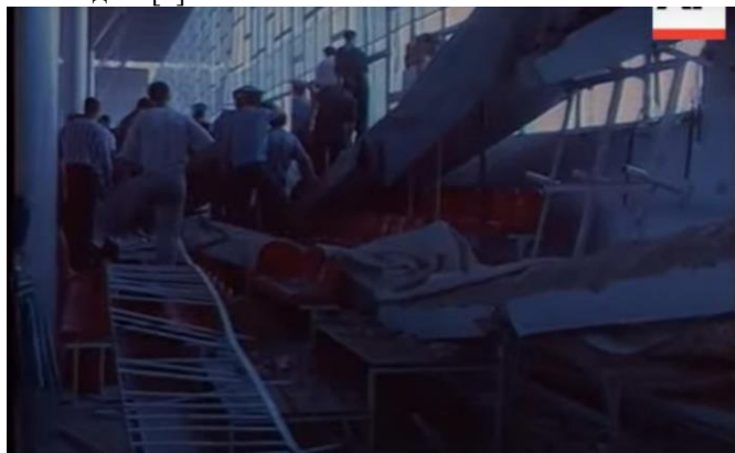
Рис. 2 «Обрушение балкона в городе Нальчик»
