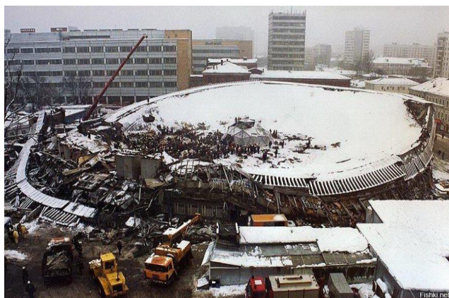
Рис. 1 «Обрушение крыши Басманного рынка»
