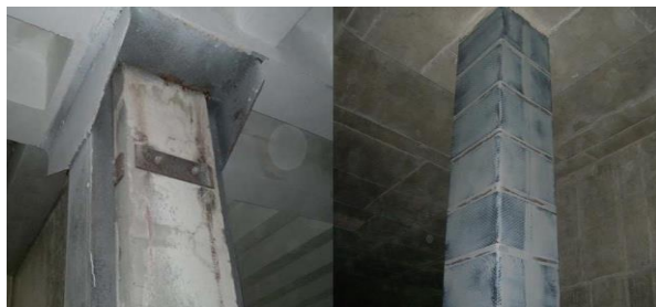
Рис. 3. Устранение коррозионности и мелких трещин в колонне в здании жилого дома в городе Москва
