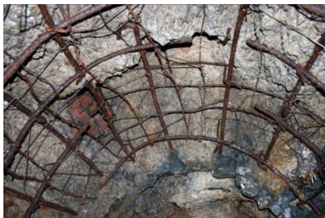
Рис. 2. Общая картина разрушения
