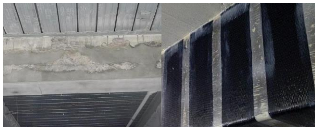
Рис. 1. Применение углепластика для устранения деформации (трещина на балке в связи с истечением срока эксплуатации) на объекте Москва Сити - Башня Федерации
