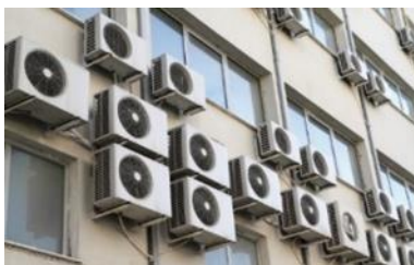
Рис .2. Чрезмерное использование систем кондиционирования воздуха
